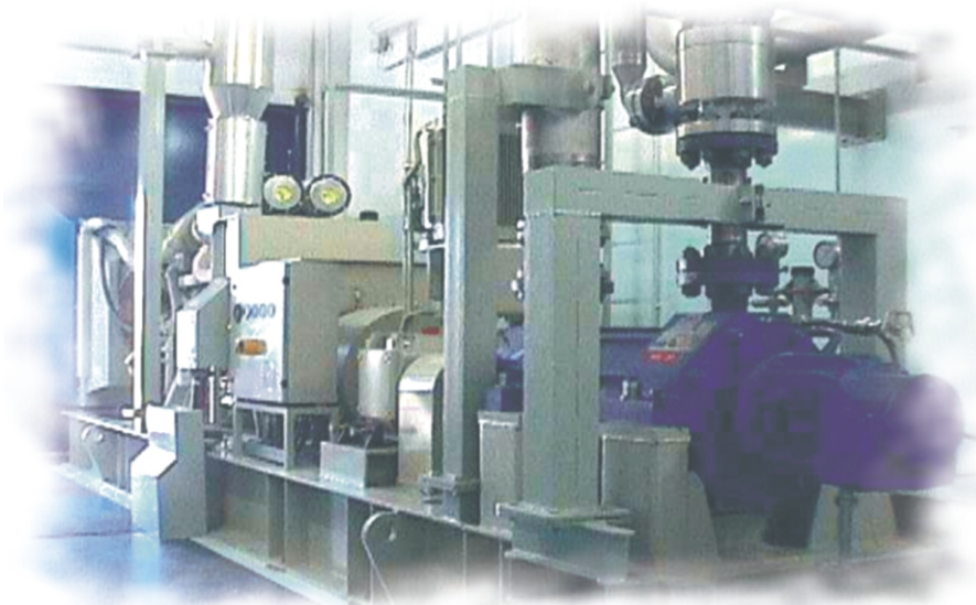
Grupo motor diesel, generador y bomba ubicada en el edificio del segundo sumidero de calor
