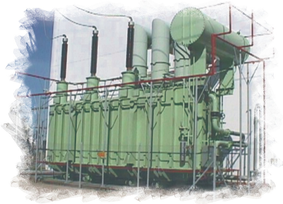
Nuevo transformador de bloque instalado en la central
