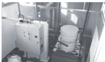
Área de Gestión Ezeiza Verificación de la calidad de bultos con residuos radiactivos acondicionados
