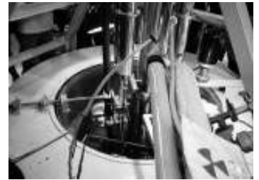
Reactor de investigación RA-1 Enrico Fermi Boca del tanque Centro Atómico Constituyentes
