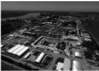
Central nuclear argentina CAREM Vista general de las obras Sitio de la Central Nuclear Atucha Unidades I y II
