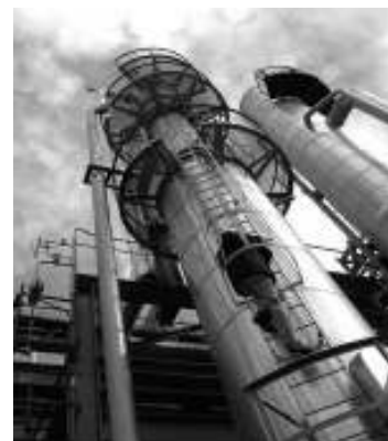
Planta Industrial de Agua Pesada Columna de amoniaco
