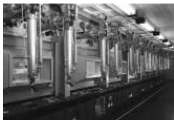
Celdas calientes construidas en el Centro Atómico Ezeiza por INVAP S.E.
