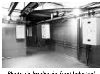
Planta de Irradiación Semi Industrial Sistema de transporte del material a irradiar - Centro Atómico Ezeiza
