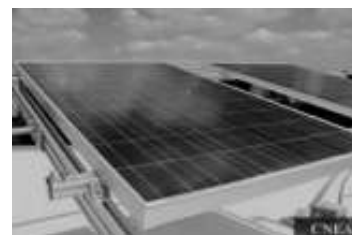
Paneles fotovoltaicos conectados a la red interna Centro Atómico Constituyentes
