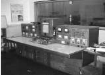
Consola de control del Reactor de investigación RA-0 Universidad Nacional de Córdoba
