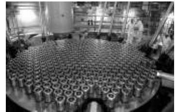
Central Nuclear Atucha - Unidad II Canales para los elementos combustible
