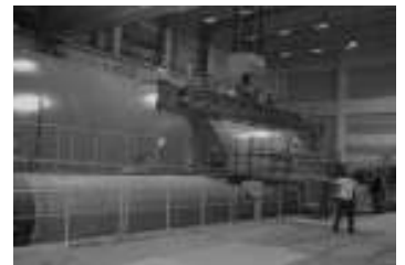
Central Nuclear Atucha – Unidad II Turbinas de baja presión
