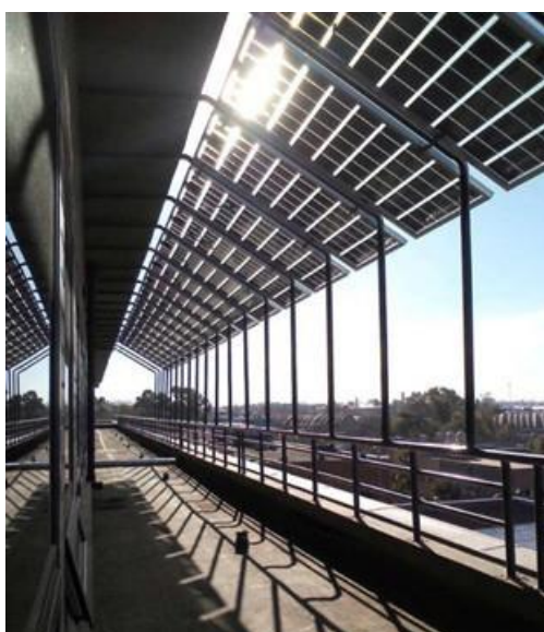
Figura III-1: Fotografía de pérgola instalada Edificio TANDAR.
