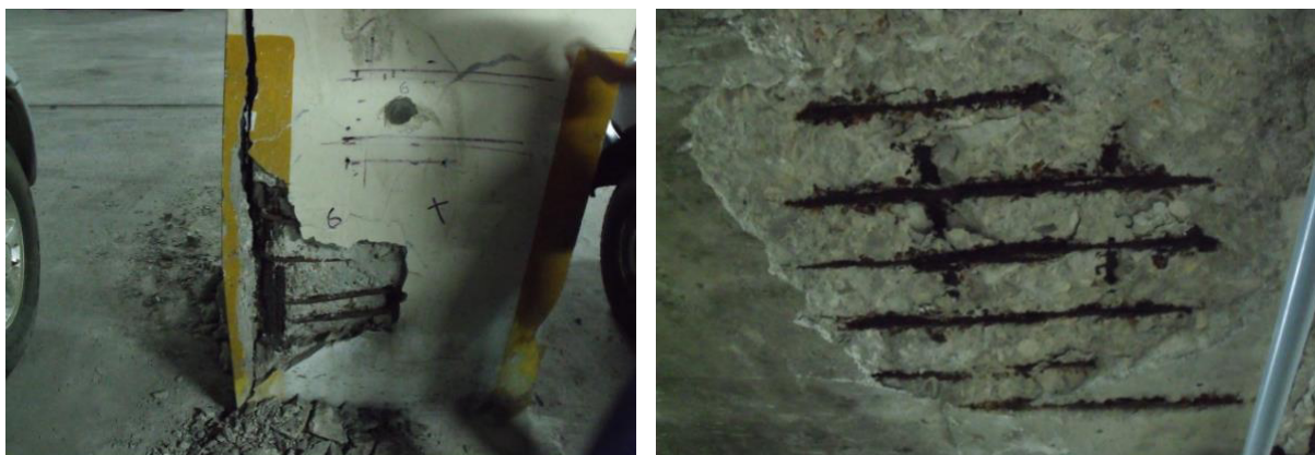
Figura 11. Acero de refuerzo expuesto en columna y viga de hormigón con daños por carbonatación, en la ciudad de Guayaquil. Fuente: Autor.
