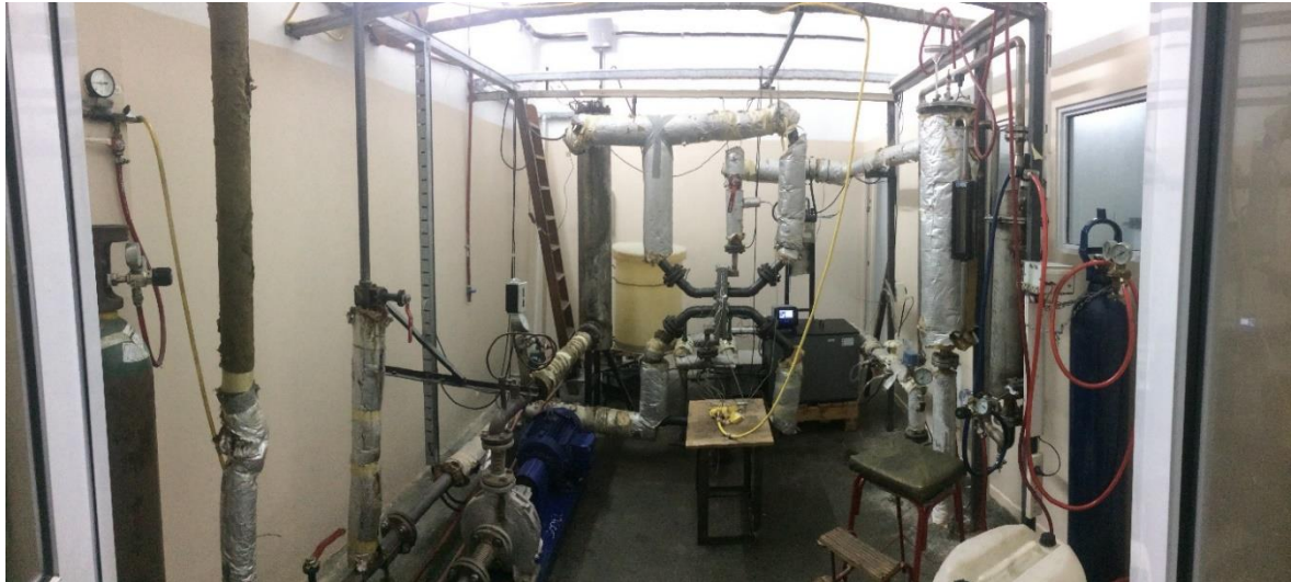
Figura 2.1. Vista general del “Loop de Oxidación”.
