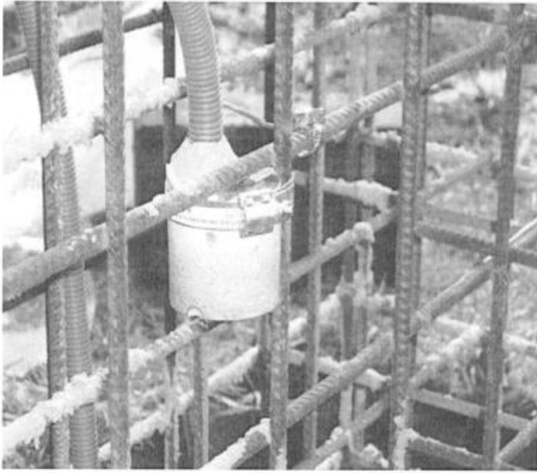
Figura 3.10. Detalle de un sensor adherido a la armadura
