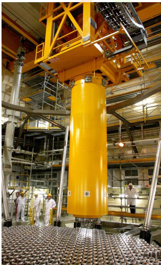
Máquina de recambio de combustible - Central Nuclear Atucha II.
