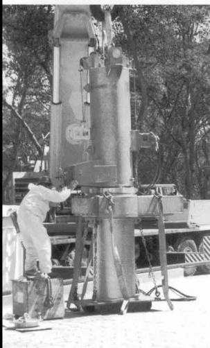
Acople del blindaje con el bulto intermediario para cargar los elementos combustibles gastados, en el casco del transporte.
