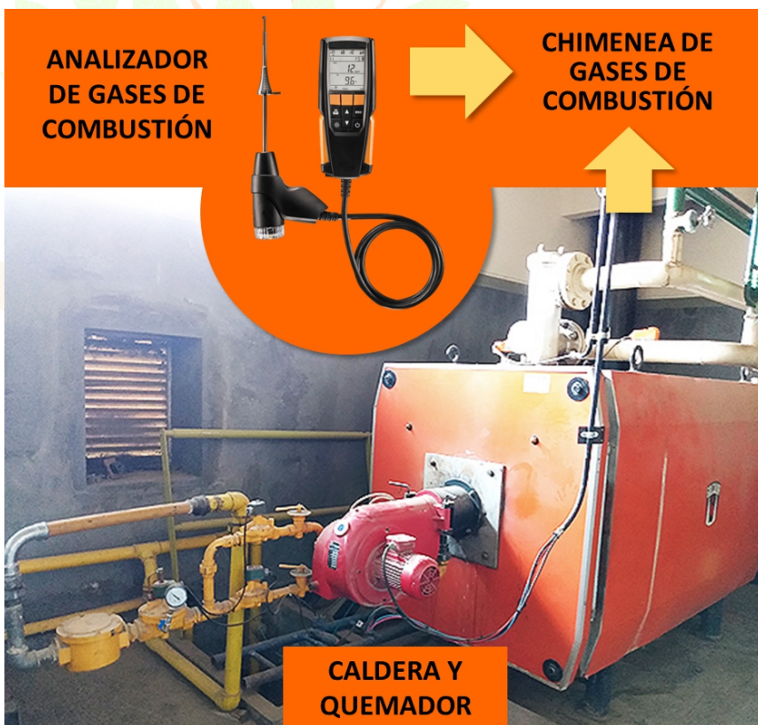
Caldera de calefacción y analizador de gases de combustión. Los sensores de la sonda se introducen en la chimenea de gases de combustión para medir contenido de oxígeno, monóxido de carbono, temperatura del gas y temperatura ambiente. A partir de estos datos el instrumento calcula el dióxido de carbono, el rendimiento y las pérdidas.
