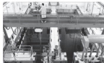
Área temática Seguridad nuclear y ambiente - Piletas para almacenamiento temporario de elementos combustibles gastados - Central Nuclear Atucha I
