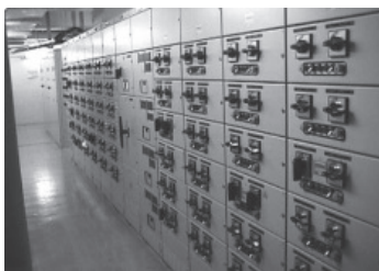
Proyecto Soporte tecnológico a la construcción y puesta en marcha de la Central Nuclear Atucha II Tablero de control
