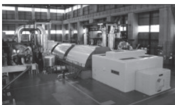
Central Nuclear Embalse Turbogenerador
