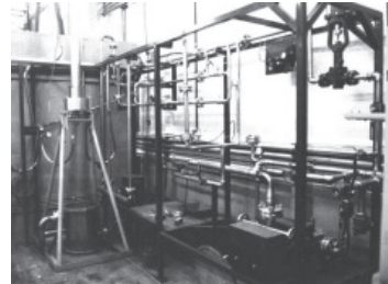
Proyecto CAREM Circuito de ensayo de mecanismos hidráulicos
