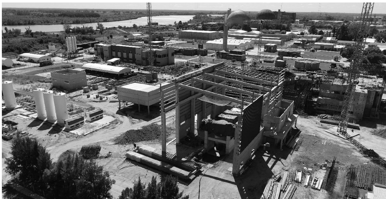
Reactor argentino CAREM, vista del edificio del turbo grupo. Lima, Provincia de Buenos Aires.
