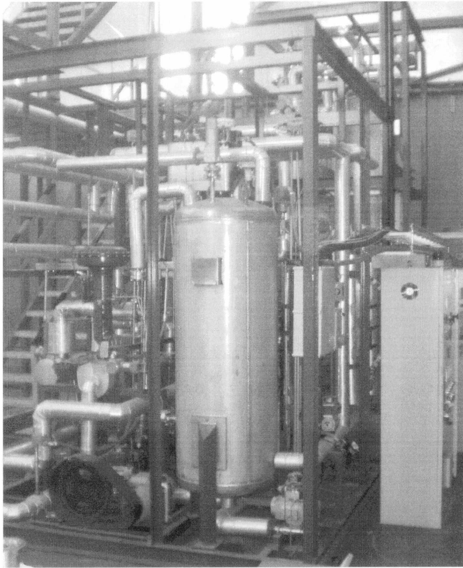
Figura 3.1: Foto del Sistema de Refrigeración, vista frontal.
