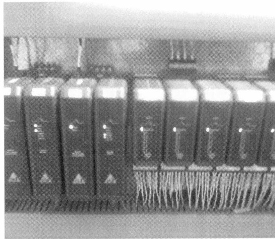
Figura 3.6: El controlador DeltaV en el tablero de control.
