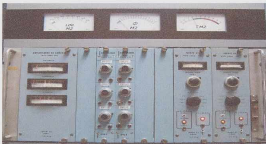
Figura 8 Canal de marcha para medición de flujo logarítmico (CIC1, CIC2, CIC3)
