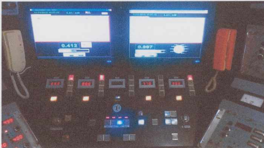
Figura 17. Registradores de posición de las barras de control
