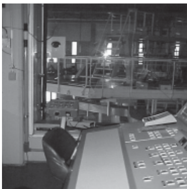
Reactor de investigación RA 6 Sala de control
