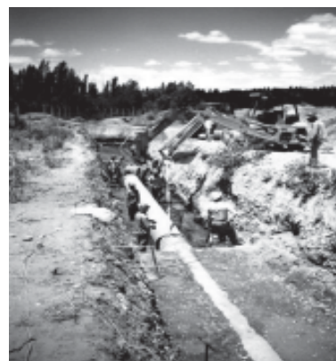
Proyecto Restitución Ambiental de la Minería del Uranio (PRAMU): ex Complejo Minero Fabril Malargüe - Sistema de drenaje de aguas superficiales y subterráneas
