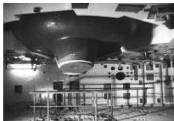
Central Nuclear Atucha II Vista inferior del generador de vapor
