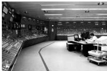
Central Nuclear Embalse Sala de Control
