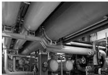
Central Nuclear Atucha II Tuberías principales
