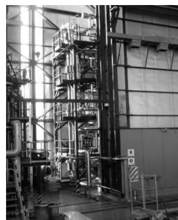
Proyecto CAREM Circuito de Alta Presión para Ensayo de Mecanismos Centro Atómico Ezeiza
