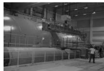
Central Nuclear Atucha II Turbinas de baja presión
