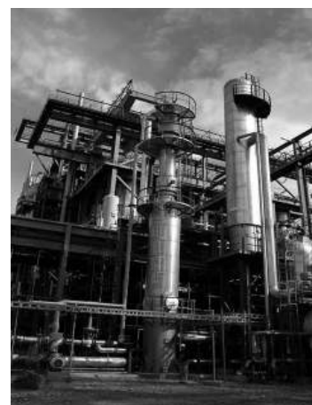
Planta Industrial de Agua Pesada Columna de amoniaco
