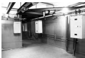
Planta de Irradiación Semi Industrial Sistema de transporte de material a irradiar - Centro Atómico Ezeiza Pcia. de Buenos Aires
