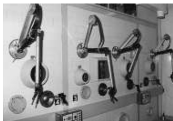
Laboratorio de Facilidades Radioquímicas (LFR) Celdas con telemanipuladores Centro Atómico Ezeiza
