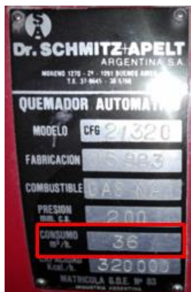
Figura 6 – Placa del quemador de la caldera
