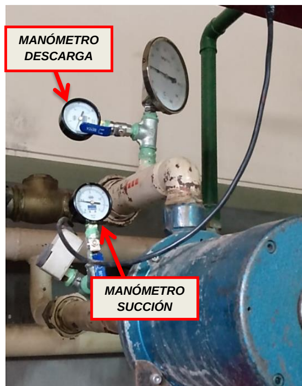
Figura 14 - Manómetros en los caños de succión y descarga de la bomba de recirculación
