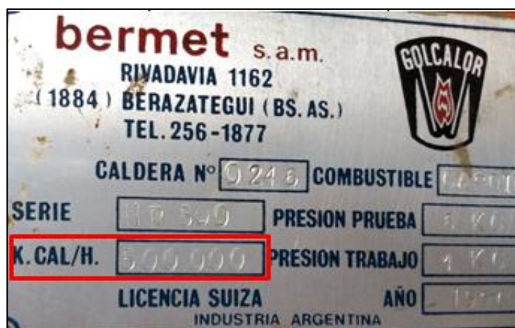
Figura 15 - Placa de la caldera
