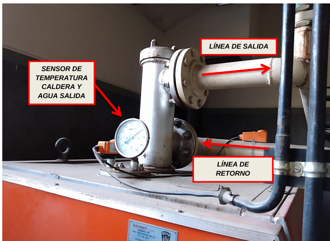
Figura 3 - Sensor de temperatura del agua de la caldera
