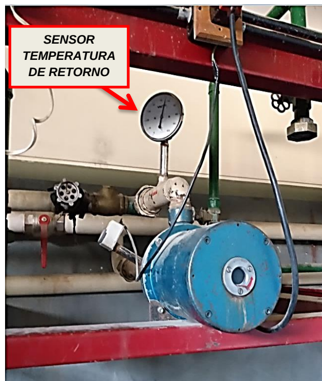
Figura 5 - Bomba de recirculación
