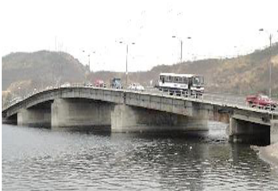
Figura 1.1. Corrosión marina en las pilas del puente "Portete" al sur de Guayaquil, en el Estero Salado. Fuente: Autor.
