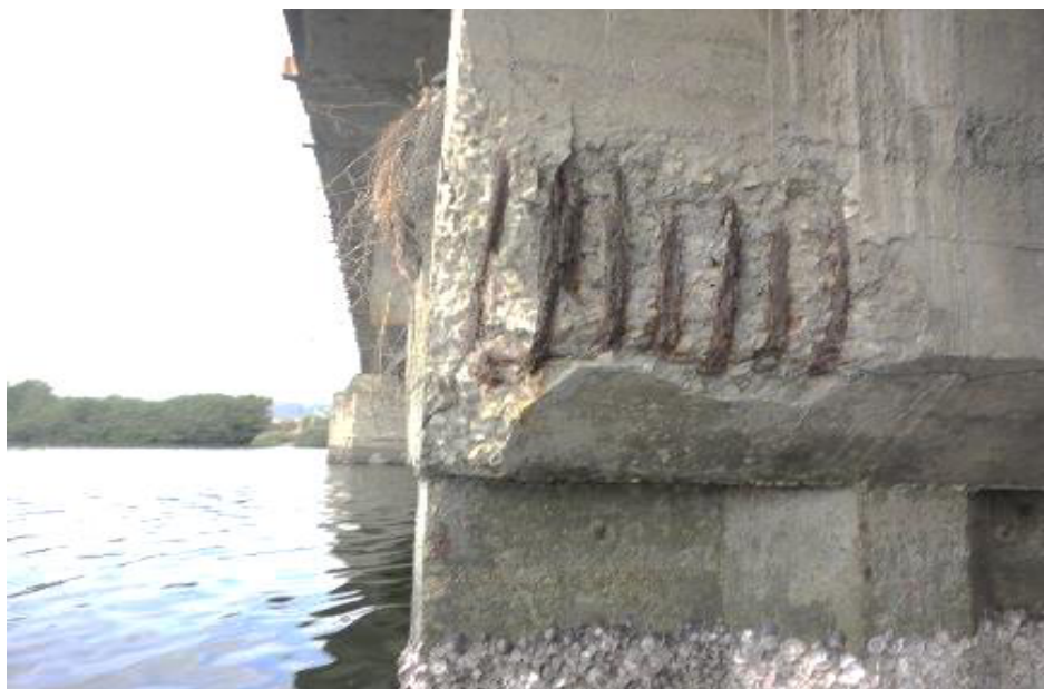
Figura 1.2. Detalle de la caída del revestimiento y armaduras de acero expuestas en el puente "Portete". Fuente: Autor.
