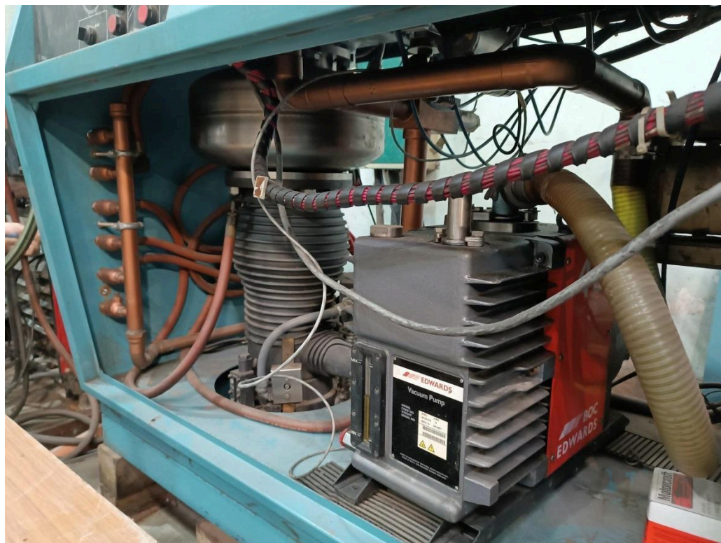
Figura 5 - Sistema de bombeo de vacío
