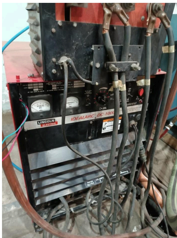
Figura 7- Fuente DC 1000 instalada y conectada a placa ESP 32 para adquisición de datos de tensión y corriente (cables celeste - rosa - gris, izquierda arriba)
