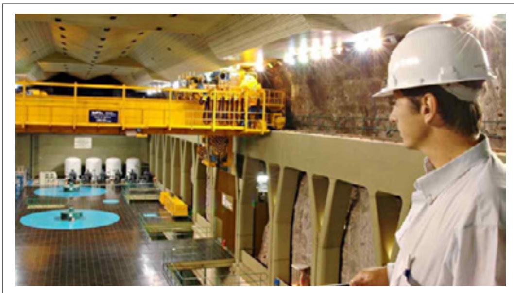
Figura 2: Sala de máquinas de la central de bombeo de Río Grande, Córdoba.
