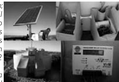
Sistema de energía en el detector AMIGA: Arriba, izquierda, instalando un panel solar; arriba a la derecha, caja de baterías adjuntas a un detector de superficie; abajo a la izquierda, la misma caja cerrada; y abajo a la derecha, el regulador del panel solar que alimenta a las baterías.
