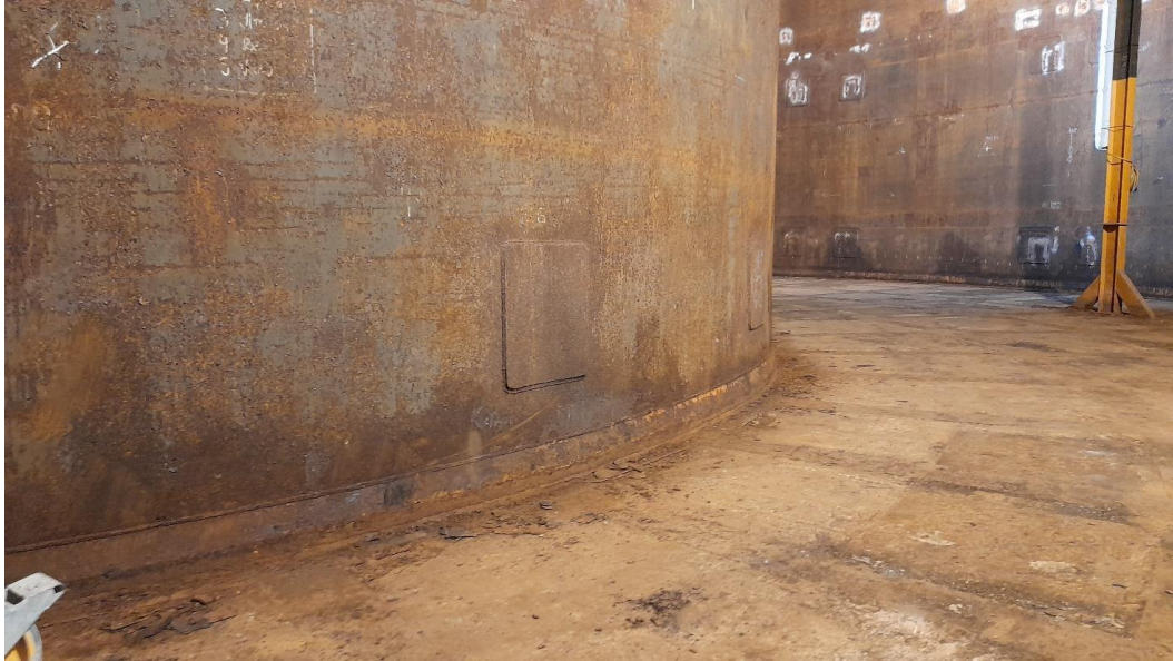
Figura 35: Corrosión generalizada en el Módulo 2 (pared izquierda) y desnivel del Módulo 1 (suelo).
