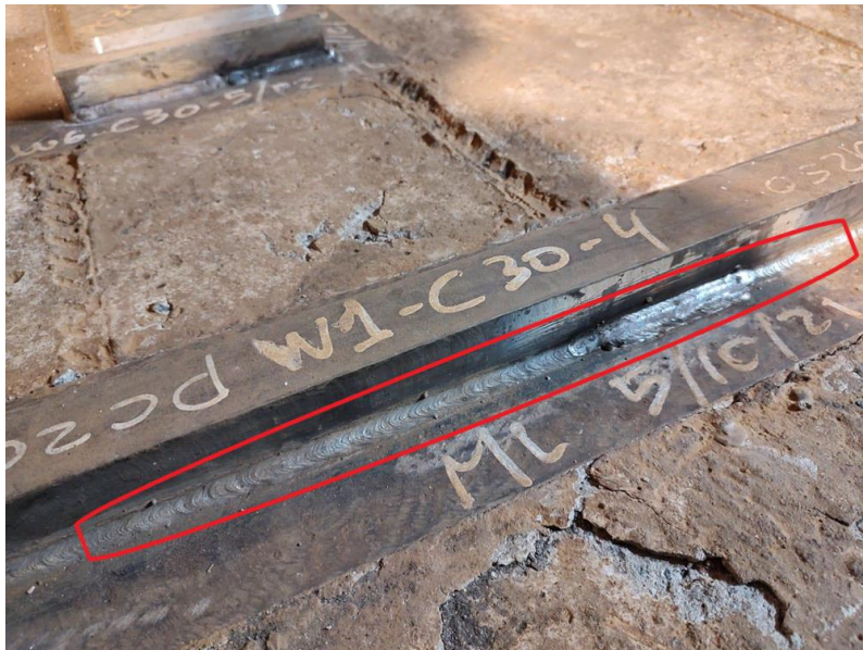
Figura 41: Soldaduras en sectores gargantas con menos de 5 mm.
