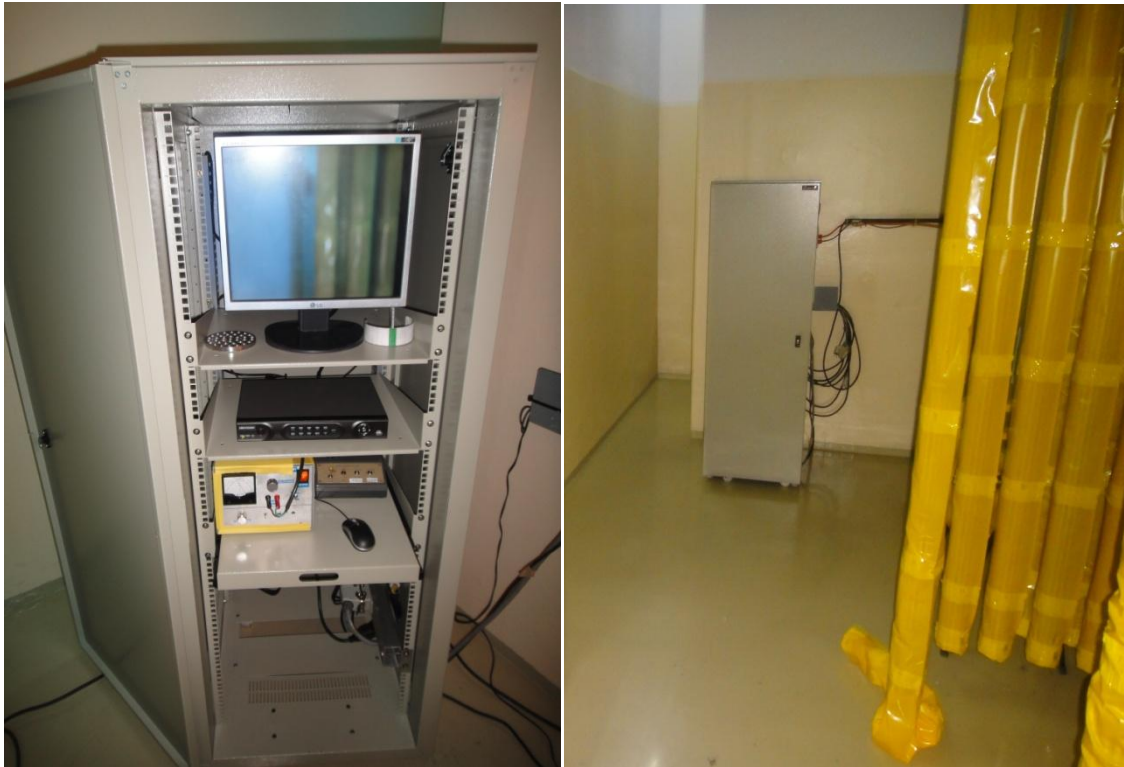
Figura 36: Imagen del sistema de inspección de E.C.s nuevos actualizado montado en su posición en Edificio de piletas 2.
