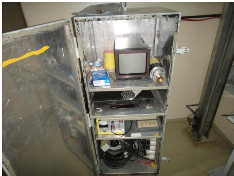
Figura 24: Foto del sistema implementado en casa de piletas 2 para inspección de E.C.s nuevos.
