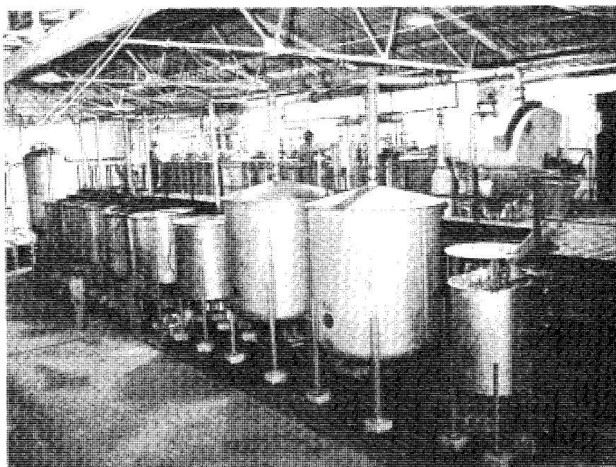
Planta de Purificación por T. B. P. en el Complejo Fabrill Córdoba
