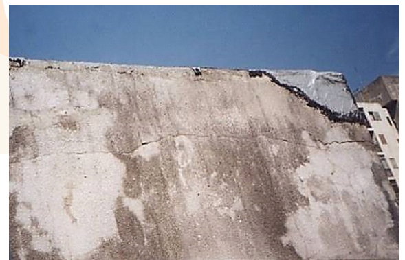
Fisura de coronamiento 1 , vestigios de membrana asfáltica, manchas de humedad. (Fuente: PMH - FADU - UBA)
