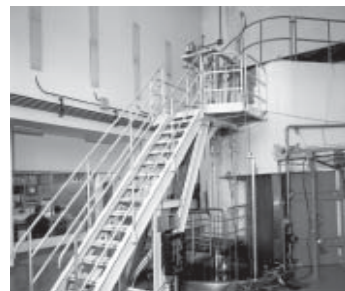
Reactor para investigación y producción de radioisótopos RA 3 (repotenciado de 5 a 10 MW) - Centro Atómico Ezeiza
