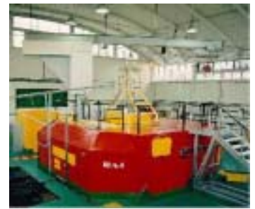
Reactor para investigación de daño por irradiación y análisis por activación RA 1 Centro Atómico Constituyentes
