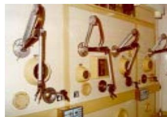
Proyecto LFR - Celdas blindadas con telemanipuladores
