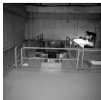
Proyecto LAPEP: Laboratorio de Ensayos Pos Irradiación. Pileta de recepción de elementos combustibles gastados - Centro Atómico Ezeiza
