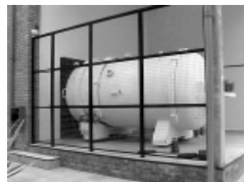
Proyecto Antena radar de apertura sintética: Autoclave instalada en el edificio ARAS Centro Atómico Constituyentes
