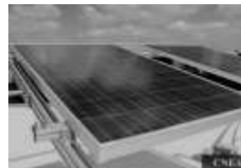
Paneles fotovoltaicos conectados a la red interna del Centro Atómico Constituyentes
