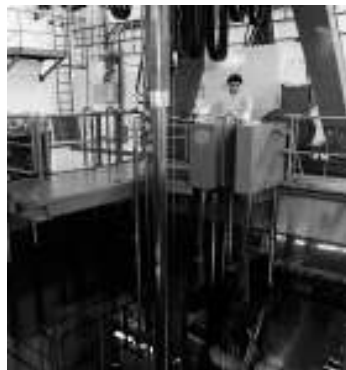
Pileta de almacenamiento temporario de elementos combustibles gastados Central Nuclear Embalse
