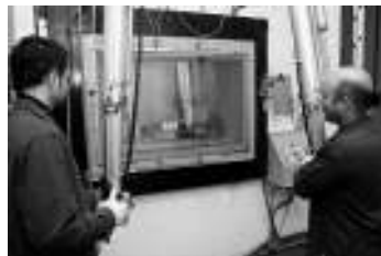
Planta de Producción de Radioisótopos Celdas blindadas con telemanipuladores Centro Atómico Ezeiza
