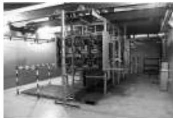
Planta de Irradiación Semi Industrial Centro Atómico Ezeiza
