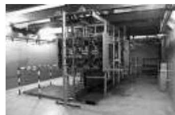
Planta de Irradiación Semi Industrial Centro Atómico Ezeiza Provincia de Buenos Aires
