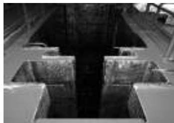
Laboratorio de Ensayos Pos Irradiación (LAPEP) - Pileta de corte de elementos combustibles gastados Centro Atómico Ezeiza
