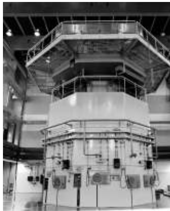
Reactor de investigación RA-6 Centro Atómico Bariloche
