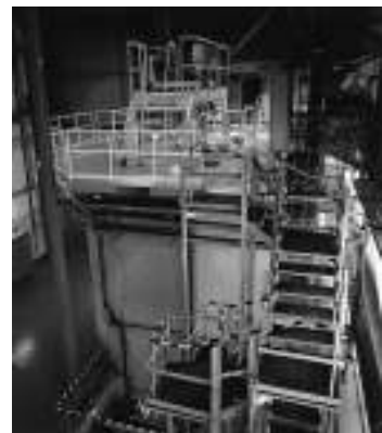
Reactor de investigación RA-8 Facilidad crítica para reactor CAREM Centro Tecnológico Pilcaniyeu
