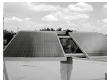
Paneles fotovoltaicos conectados a la red interna del Centro Atómico Constituyentes.
