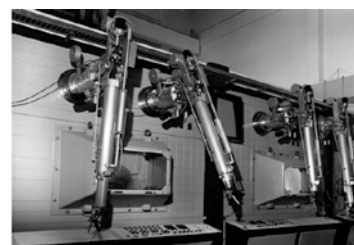
Planta de Producción de Molibdeno-99 Celdas blindadas con telemanipuladores Centro Atómico Ezeiza Pcia. de Buenos Aires
