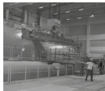
Central Nuclear Néstor Kirchner (ex Atucha II) Turbinas de baja presión
