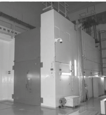
Central Nuclear Néstor Kirchner (ex Atucha II) Edificio de piletas de elementos combustibles
