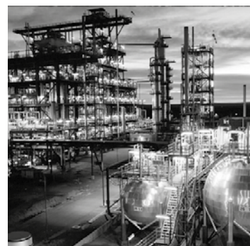
Planta Industrial de Agua Pesada operada por ENSI S.E. en Arroyito - Pcia. del Neuquén
