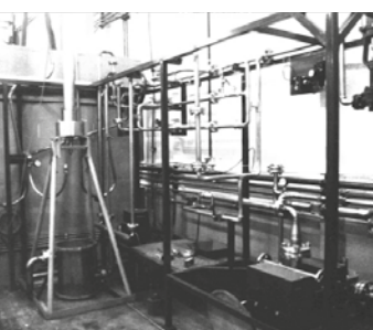
Proyecto CAREM Circuito de Baja Presión para Ensayos Hidrodinámicos
