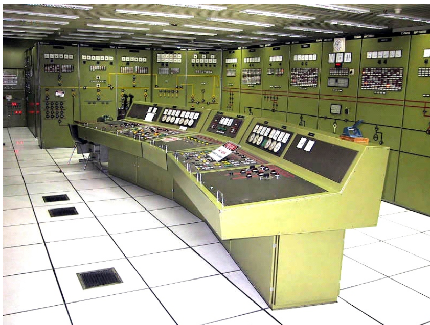
Figura 6. Sala de Comando
