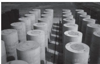
Central Nuclear Embalse Almacenamiento temporal en silos de elementos combustibles gastados Central Nuclear Embalse
