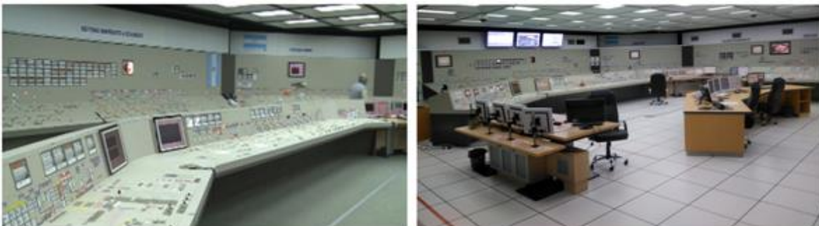
Imagen N°2: Comparación entre Sala de Control (izq.) y Simulador de Alcance Total (der.)
