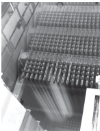
Central Nuclear Embalse Pileta de almacenamiento temporal de elementos combustibles gastados
