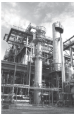
ENSI S.E. Planta Industrial de Agua Pesada Columna de amoníaco
