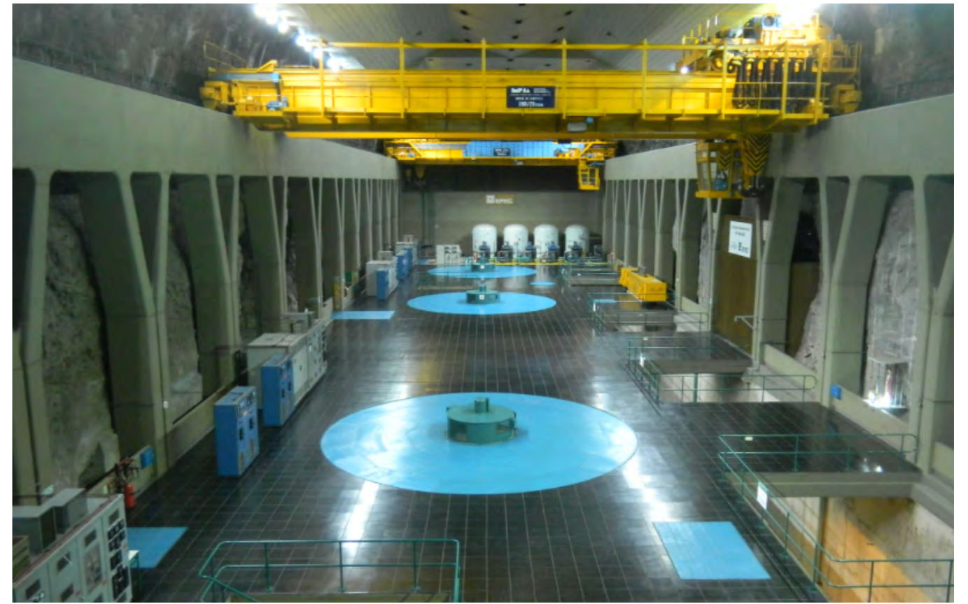
Figura 9: Sala de máquinas de la Central Hidroeléctrica Río Grande.
