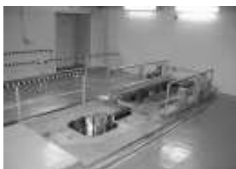
Piletas de almacenamiento de combustibles irradiados Facilidad Almacenamiento Combustible Irradiado Reactores Investigación (FACIRI) Centro Atómico Ezeiza
