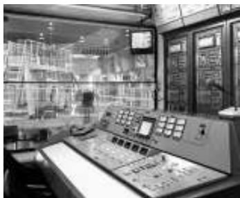
Reactor de investigación RA-6 Sala de control Centro Atómico Bariloche
