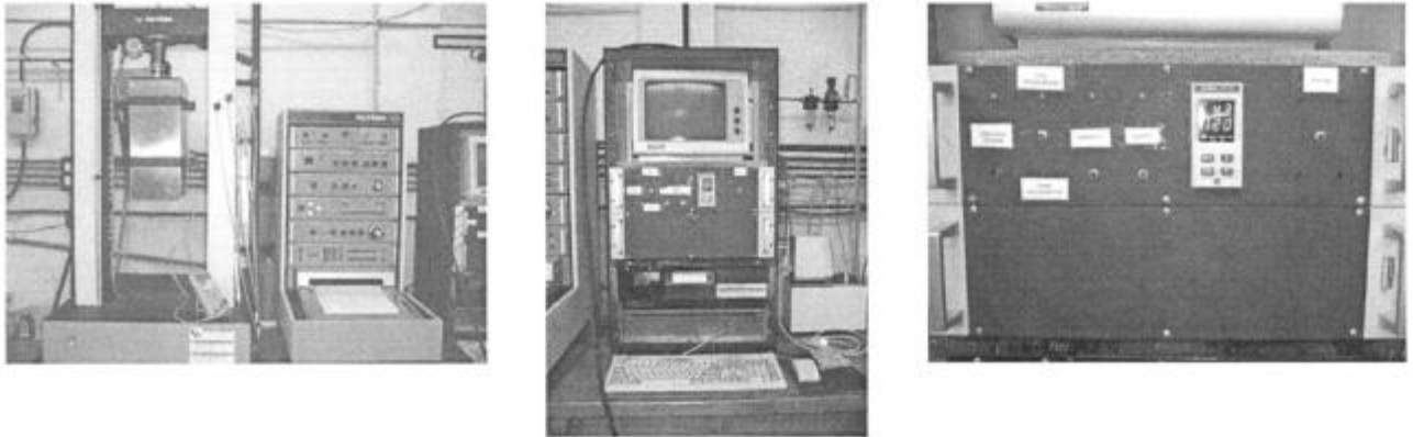
Fig.II.4.4 : en estas fotos se puede apreciar con más detalle el módulo de control y el controlador de temperatura
