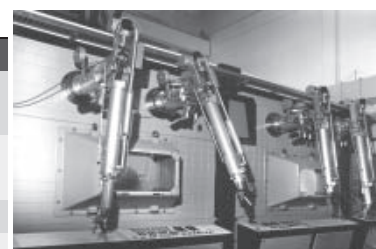
Celdas blindadas con telemanipuladores Planta de Producción de Molibdeno-99 Centro Atómico Ezeiza
